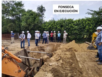
FONSECA EN EJECUCIÓN Alcantarillado sanitario y pluvial de los barrios El Carmen y El Cerrejón, Fonseca
