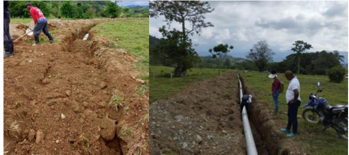
Rehabilitación de la línea de conducción del sistema de acueducto en la vereda Batatilla Acandí, Chocó
