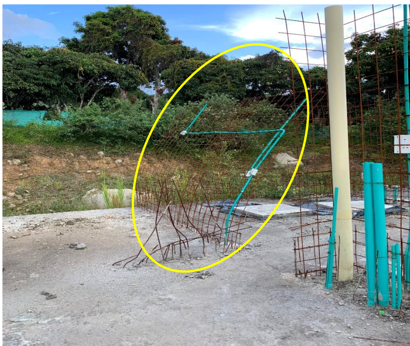
Imagen 9. Elementos eléctricos algunos instalados en las mallas electrosoldadas, otros mal acopiados torre 11, Proyecto denominado “Urbanización Santa Sofia II”, (Municipio de El Colegio, 30 de mayo de 2019, 5:00 p.m.)
