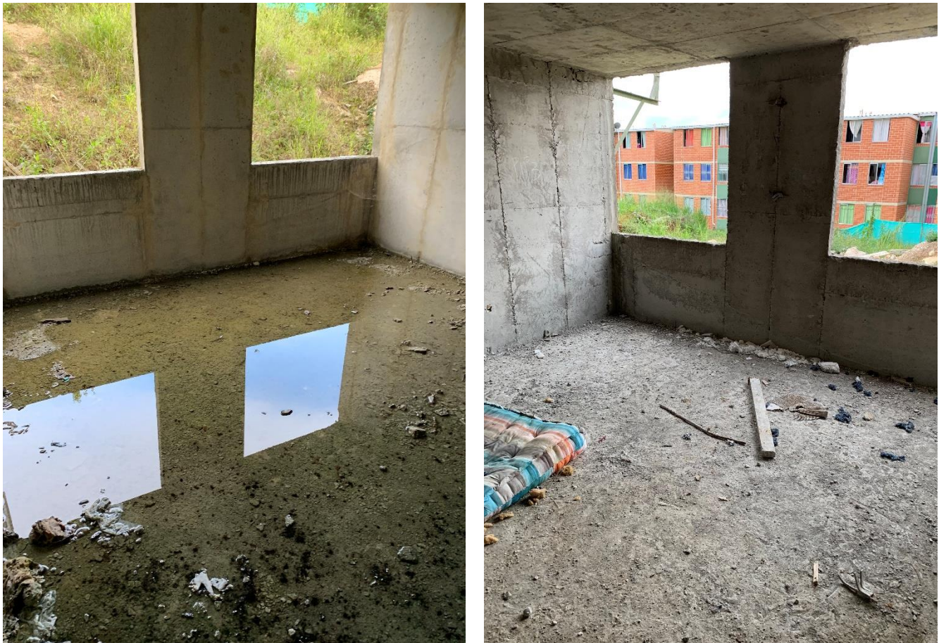
Imagen 10. Apartamentos abandonados por parte del contratista, Proyecto denominado “Urbanización Santa Sofia II”, (Municipio de El Colegio, 30 de mayo de 2019, 5:20 p.m.)
