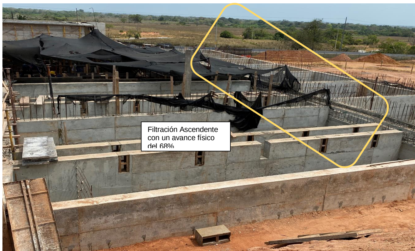
Imagen 3. Componentes de tratamiento para la PTAP con capacidad de 350 l/s perteneciente al proyecto denominado: “Construcción del Sistema de Acueducto Regional San Jorge municipios de La Apartada, Buenavista, Planeta Rica, Pueblo Nuevo”, ubicado en el departamento de Córdoba
