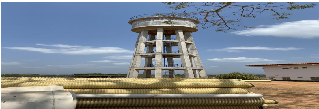
Imagen 8. Tanque de Almacenamiento de la PTAP con capacidad de 350 l/s, el cual no está conectado hidráulico del proyecto perteneciente al proyecto denominado: “Construcción del Sistema de Acueducto Regional San Jorge municipios de La Apartada, Buenavista, Planeta Rica, Pueblo Nuevo”, ubicado en el departamento de Córdoba
