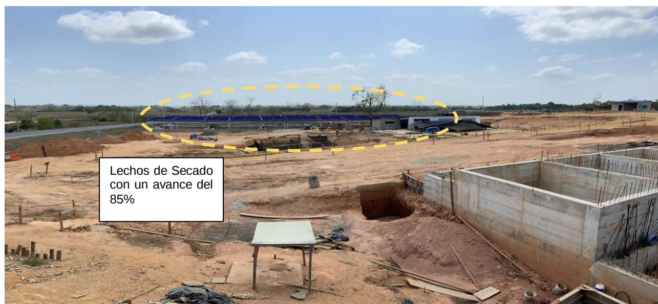
Imagen 2. Componentes de tratamiento para la PTAP con capacidad de 350 l/s perteneciente al proyecto denominado: “Construcción del Sistema de Acueducto Regional San Jorge municipios de La Apartada, Buenavista, Planeta Rica, Pueblo Nuevo”, ubicado en el departamento de Córdoba
