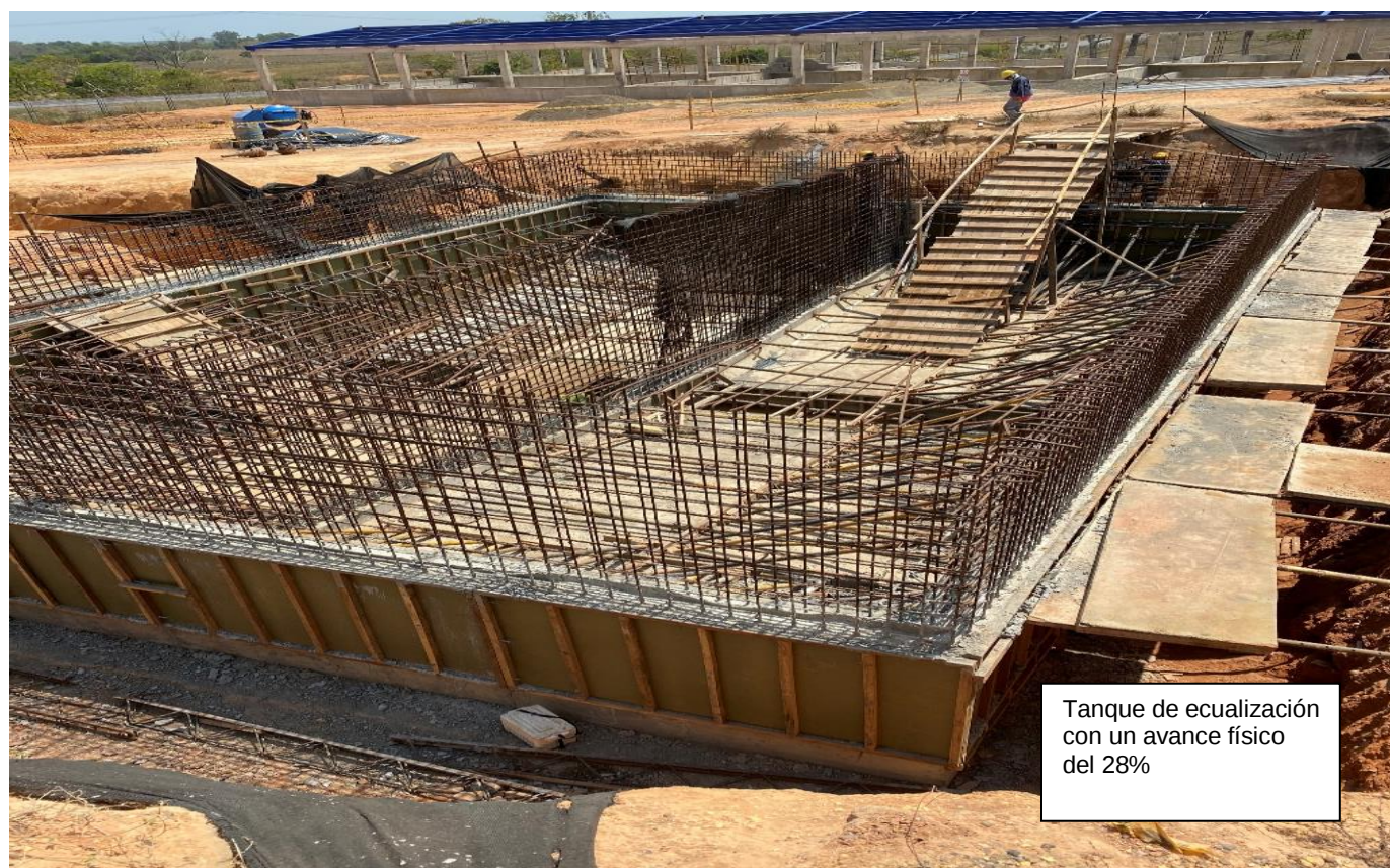
Imagen 4. Componentes de tratamiento para la PTAP con capacidad de 350 l/s perteneciente al proyecto denominado: "Construcción del Sistema de Acueducto Regional San Jorge municipios de La Apartada, Buenavista, Planeta Rica, Pueblo Nuevo", ubicado en el departamento de Córdoba
