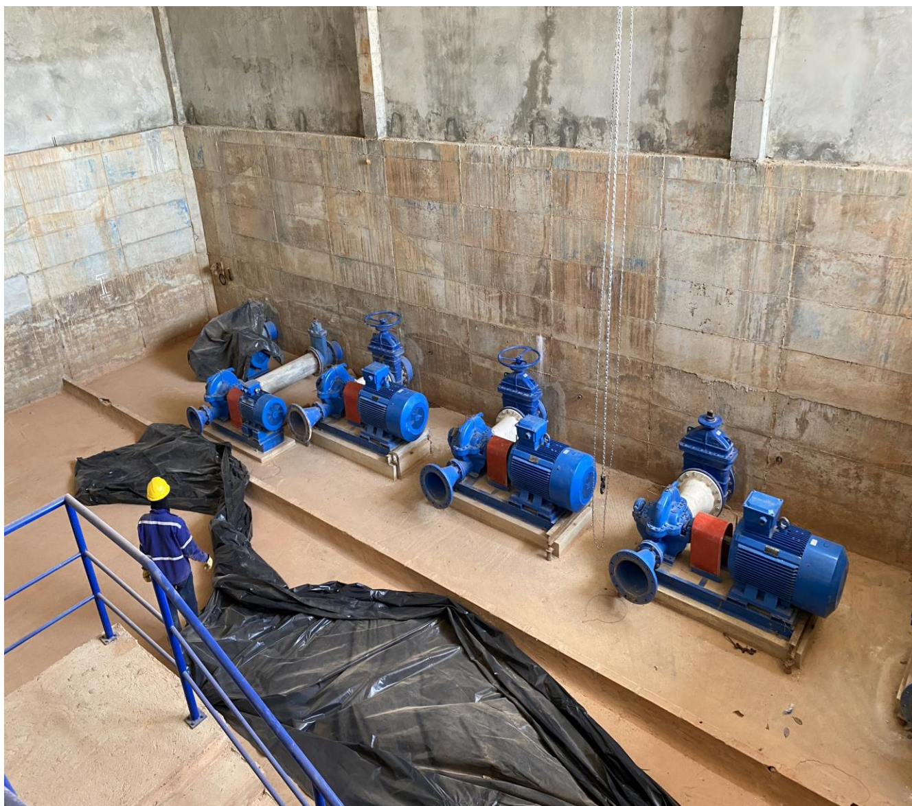
Imagen 6. Sistema de Bombeo de la PTAP con capacidad de 350 l/s, el cual no está conectado al sistema eléctrico ni hidráulico del proyecto perteneciente al proyecto denominado: “Construcción del Sistema de Acueducto Regional San Jorge municipios de La Apartada, Buenavista, Planeta Rica, Pueblo Nuevo”, ubicado en el departamento de Córdoba
