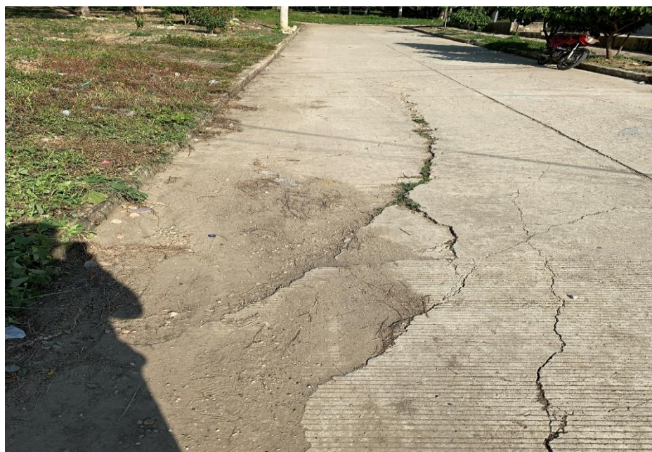
Imagen 2. Vías sin Sistema de Recolección de aguas Lluvias lo que genera empozamientos y hundimiento de banca, Proyecto denominado “Urbanización Villa Karen”, (Municipio de Sincelejo, 22 de agosto de 2019, 11:30 a.m.)
