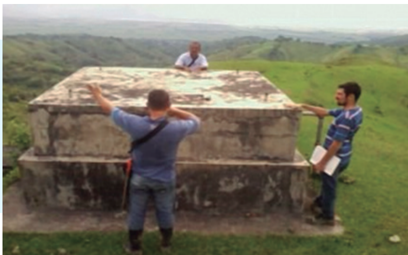
Foto 11. Tanque de almacenamiento sistema Arkos San Antonio. Guadalajara - Valle del Cauca
