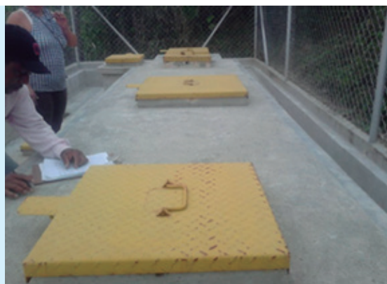
Desarenador sistema Alaska
