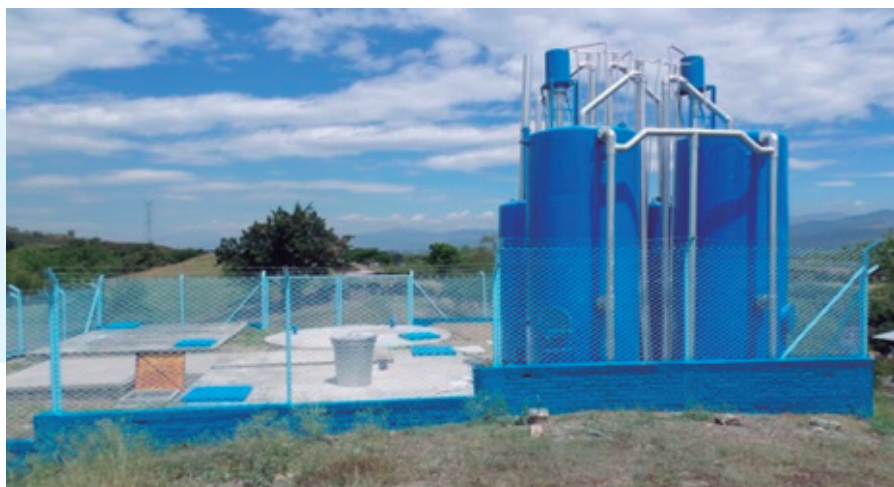
Foto 3. Planta de tratamiento de agua potable, vereda Chambimbal San Antonio. Guadalajara de Buga - Valle del Cauca
