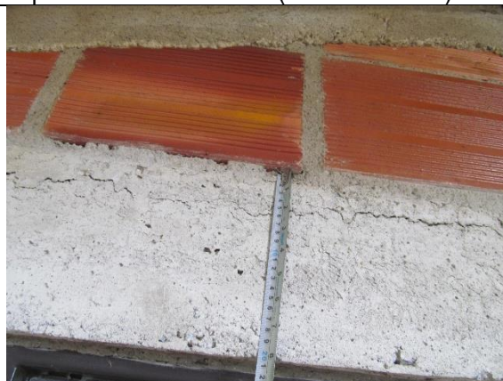
Escurrecimientos de pasta, fisuras en la viga de amarre (Lina Gisella Suárez)
