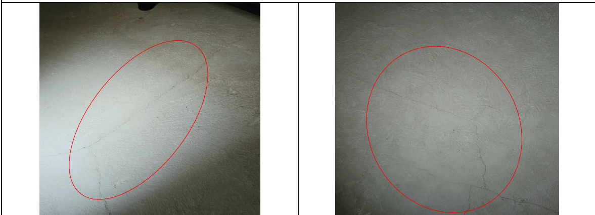
Bloque 2 Torre 4 Apto 101: Fisuras en placa de habitaciones
