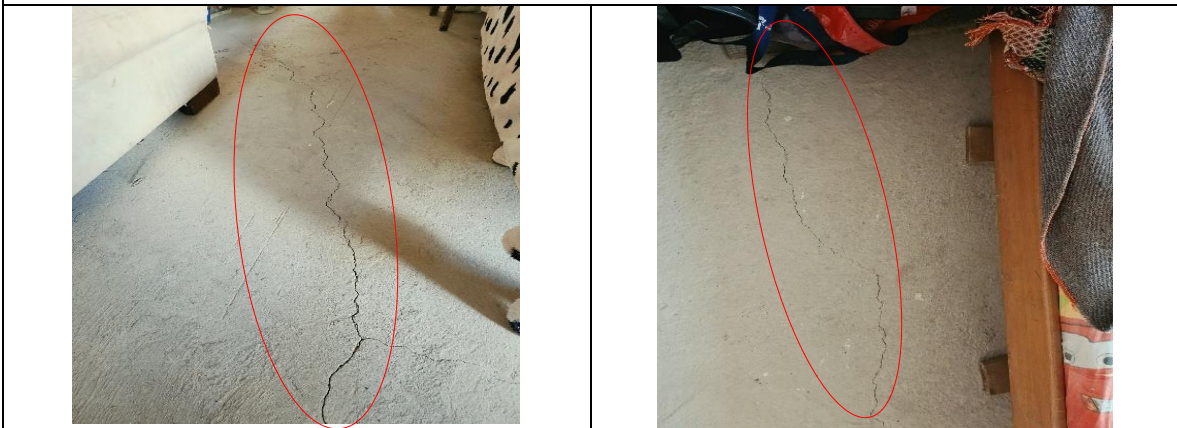
Bloque 2 Torre 3 Apto 102: Fisuras en placa de sala comedor y habitaciones
