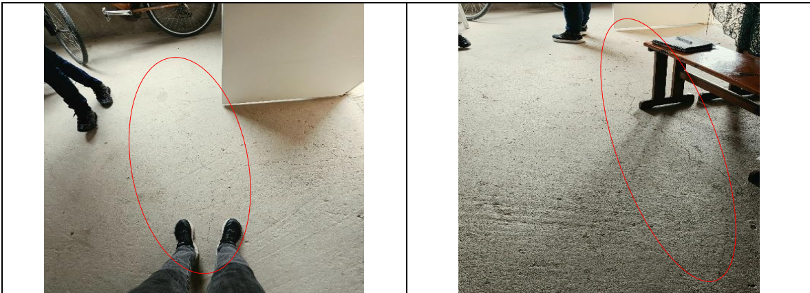
Bloque 1 Torre 2 Apto 102: Fisuras en placa de habitaciones
