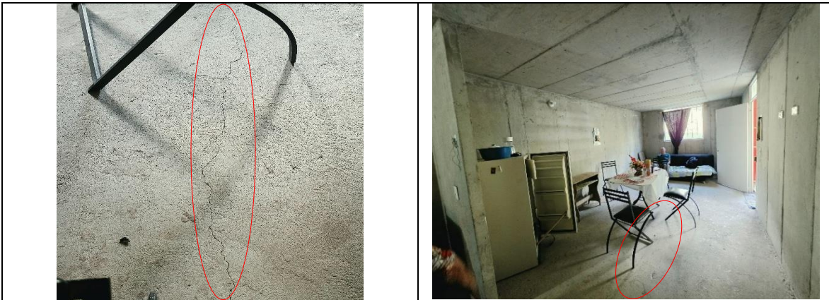
Bloque 1 Torre 3 Apto 101: Fisuras en placa de sala comedor
