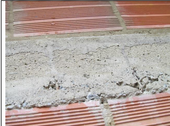
Viga con varillas sin recubrimiento, escurrimientos de pasta de mortero (Jorge Luis Malagón).
