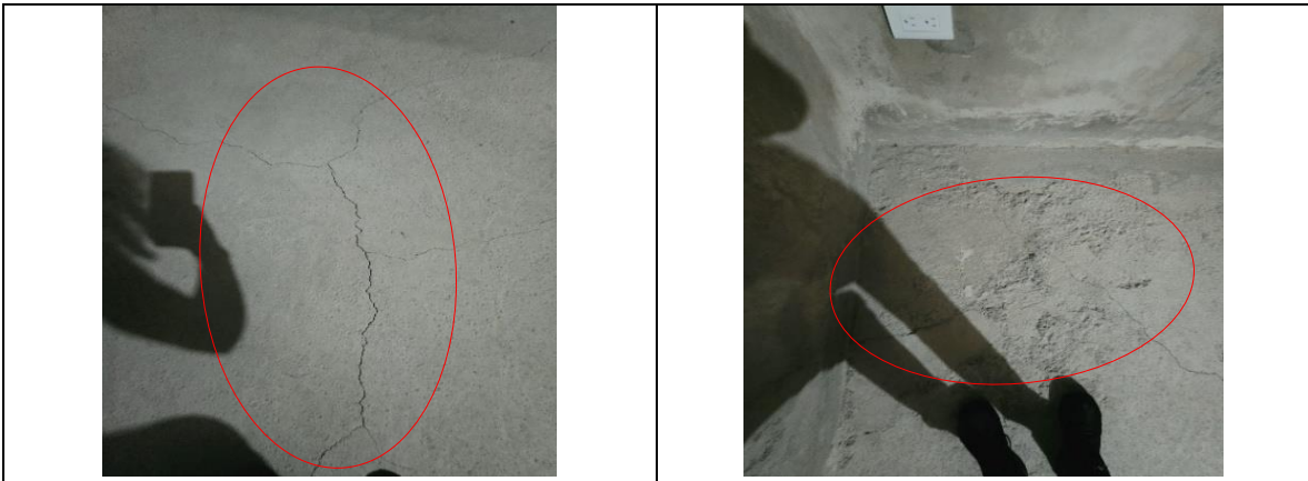
Bloque 2 Torre 3 Apto 101: Fisuras en placa de sala comedor y habitaciones y se presenta filtración de agua por vacío
