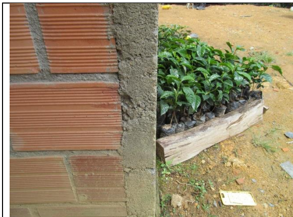
La columna en la puerta de acceso no está completamente ejecutada en sus dimensiones, la mezcla no es uniforme (Alfonso Pinzón).
