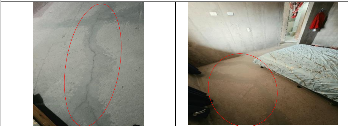
Bloque 2 Torre 2 Apto 101: Fisuras en placa de sala comedor y habitaciones
