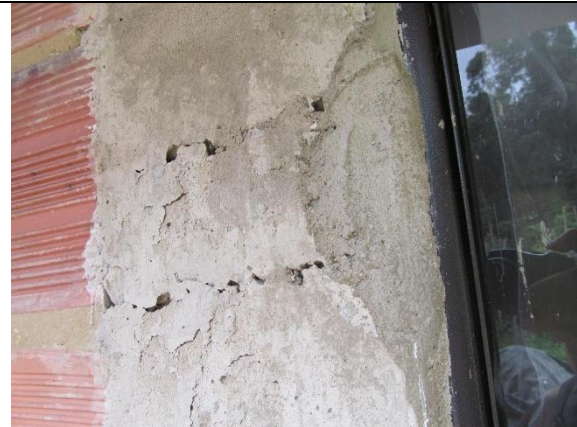
Columnas mal terminadas, con oquedades, mezcla no homogénea (Jorge Luis Malagón).
