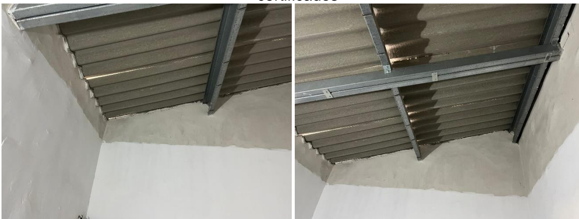
Fotografía 3: Filtración entre muro y lamina de apartamentos entre muro certificados
