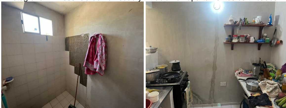
Fotografía 1: Presencia de humedad y filtración en apartamentos certificados.
