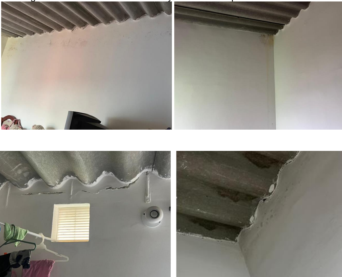
Fotografía 1: Presencia de humedad y filtración en apartamentos certificados
