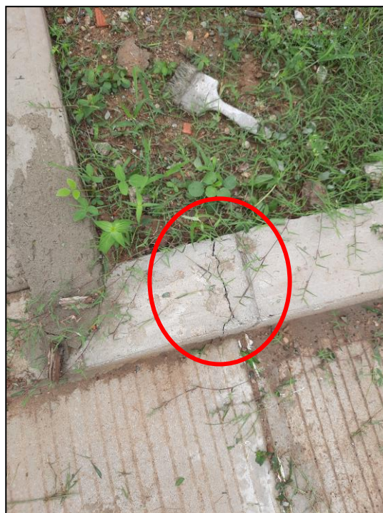
Imagen 17. Fisuras en bordillos de confinamiento del proyecto denominado: Efraín Mateus, en el municipio de San Martín, departamento del Cesar.
