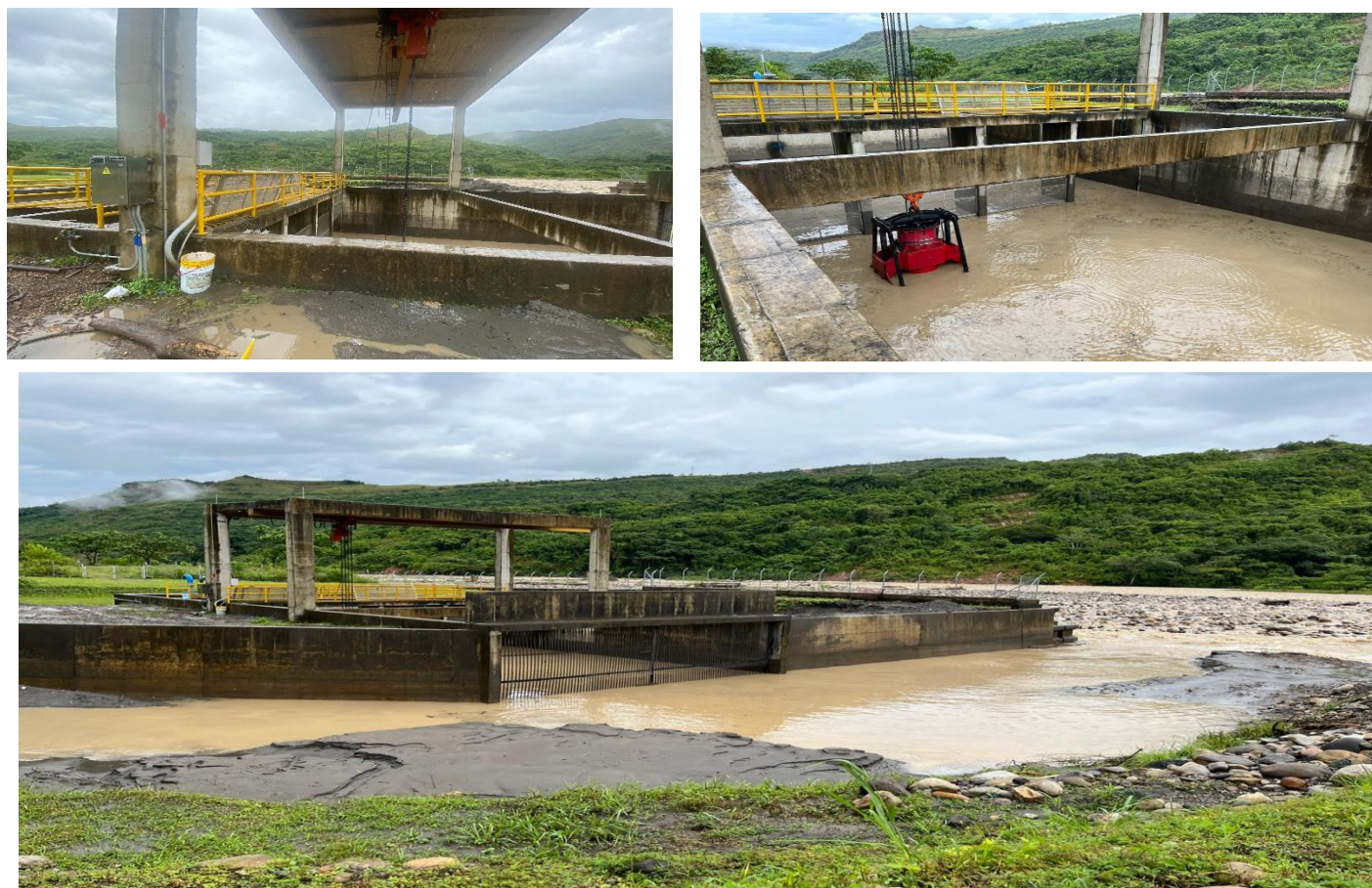
Imagen 1. Bocatoma Lateral de fondo, ubicado en el Municipio de Yopal
