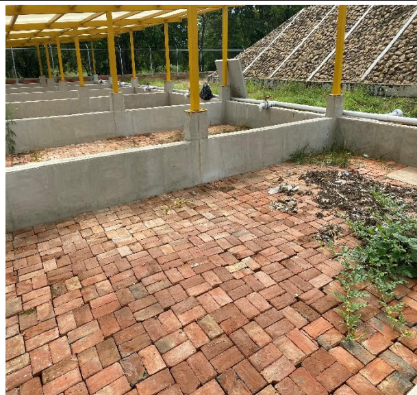
FOTO No.8 Sistema de lechos de secado, en seis módulos.
