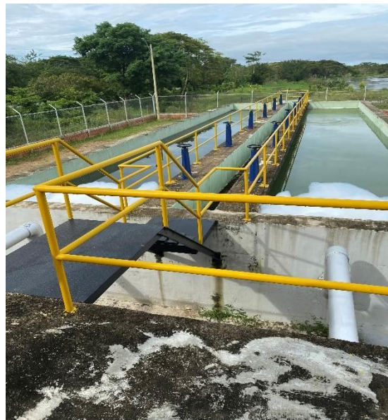
FOTO No.6 Sistema de sedimentación secundaria, en cuatro módulos.
