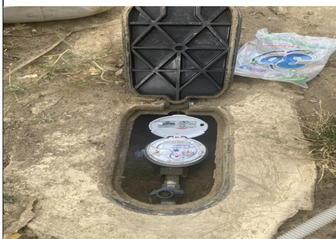
FOTO No.3: Micromedidor instalado y en funcionamiento, Corregimiento la Gallera
