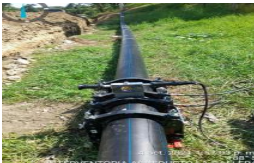
Imagen 2. Válvula de Compuerta, corregimiento de la Gallera, Municipio de Sincelejo.
