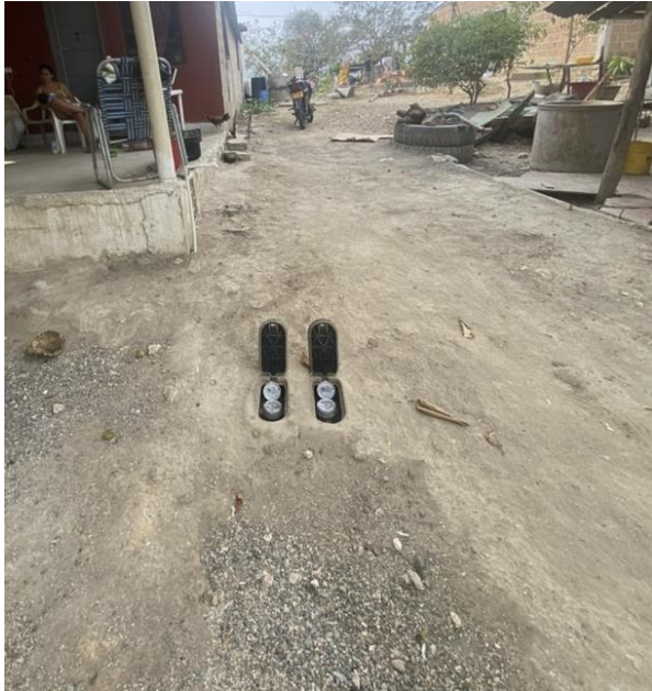
FOTO No.9 Micromedidor instalado y en funcionamiento, Corregimiento la Gallera, sector Villa Rosita
