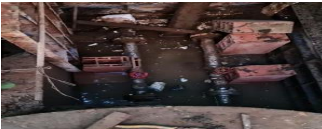
Imagen 4. Estación de Bombeo de agua residual perteneciente al Proyecto de Vivienda" Urbanización San Ignacio" Municipio de San Jose del Guaviare, Departamento del Guaviare
