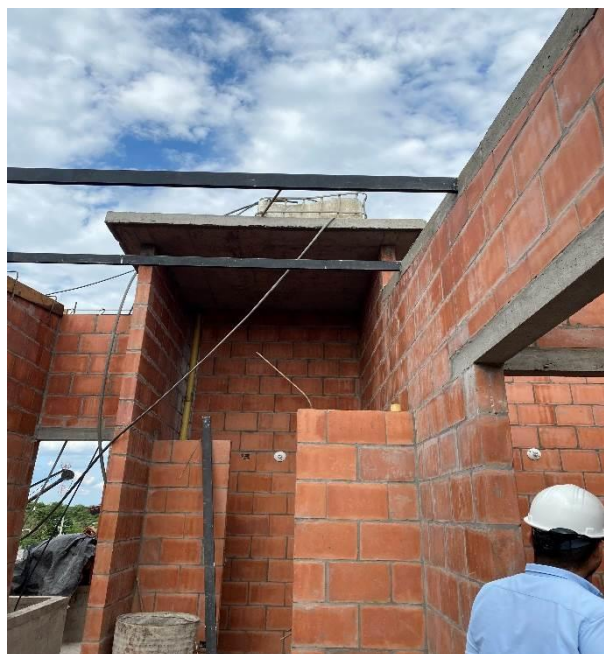
FOTO No.9 techos sin instalación de tejas torres 1, 2, y 3
