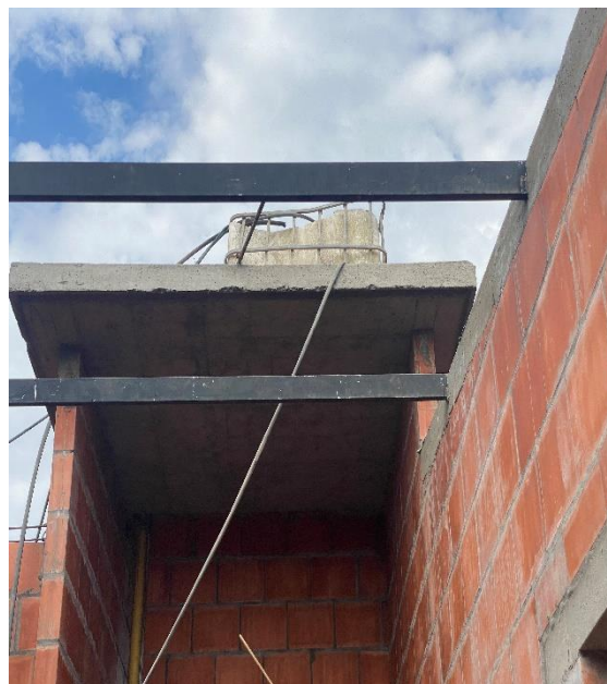
Foto 10 Placa de soporte tanque de almacenamiento torre 1 y 2
