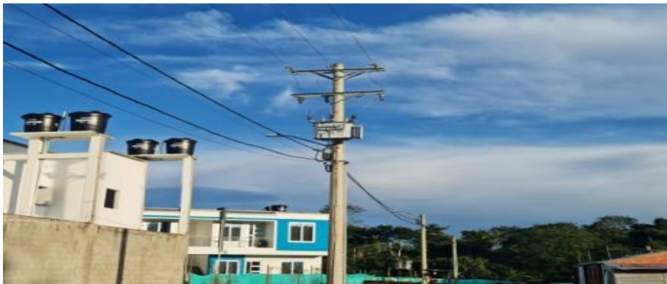
Imagen 5. Redes eléctricas perteneciente al Proyecto de Vivienda” Urbanización San Ignacio” Municipio de San Jose del Guaviare, Departamento del Guaviare
