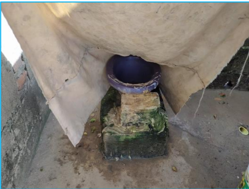
Ausencia de inodoro
