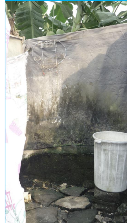
Ausencia de unidad sanitaria
