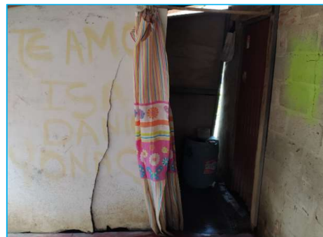
Grietas o fisuras
