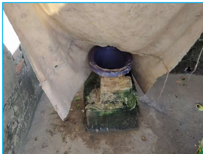
Ausencia de lavadero
