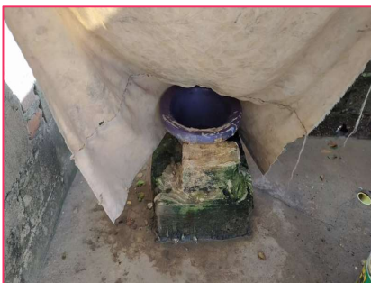
Ausencia de inodoro
