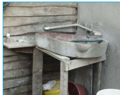
Ausencia de lavadero
