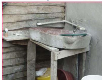
Ausencia de lavamanos
