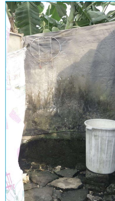
Ausencia de lavadero
