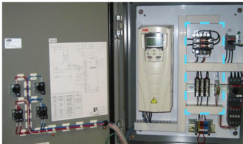
Gráfico 17. Variadores de velocidad para bombas
